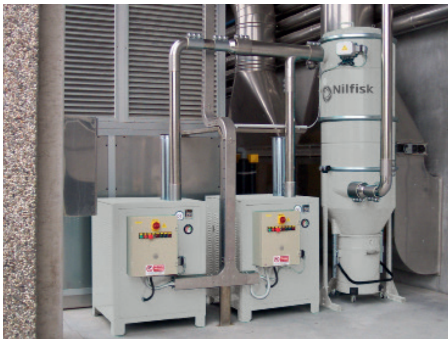
Aspiration centralisée en industrie chimique : 2 unités aspirantes, 1 silo
