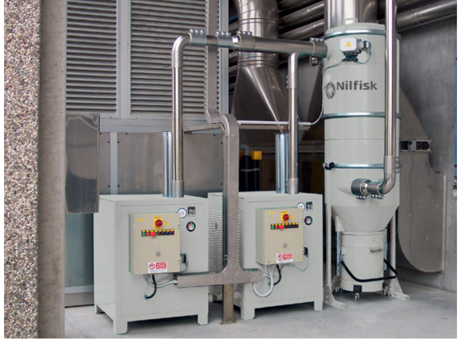
Bir kimya şirketinde merkezi vakum sistemi: 2 vakum ünitesi, 1 filtre silosu.
